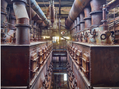
Die Trockengasreinigungen, Innenraum der TGR II
